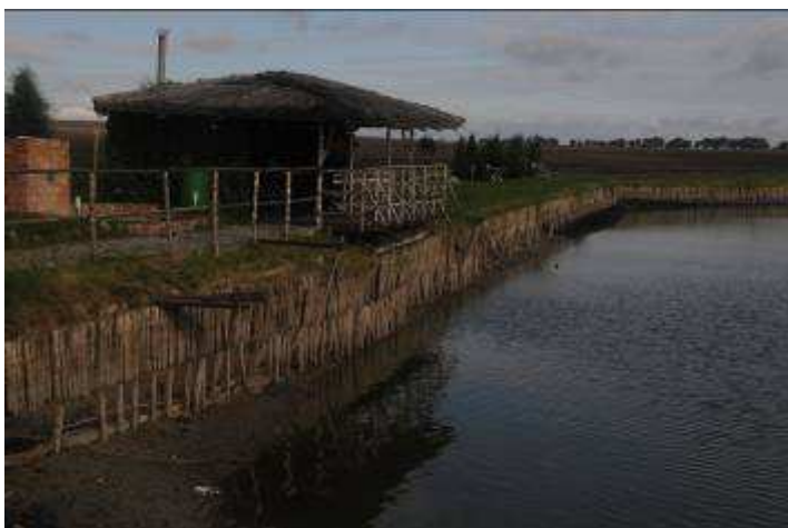
Falowanie, zimowa kra na zbiorniku, duże ryby chodowlane przyczyniają się do erozji brzegu i osuwaniu się palisady.
