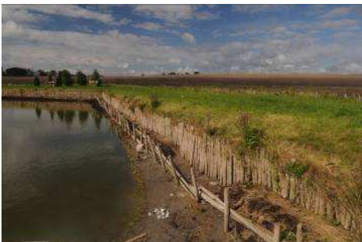
Kołki drewniane oraz faszyna wiklinowa ulegają zniszczeniu i nie są w stanie utrzymać osuwającej się skarpy.
