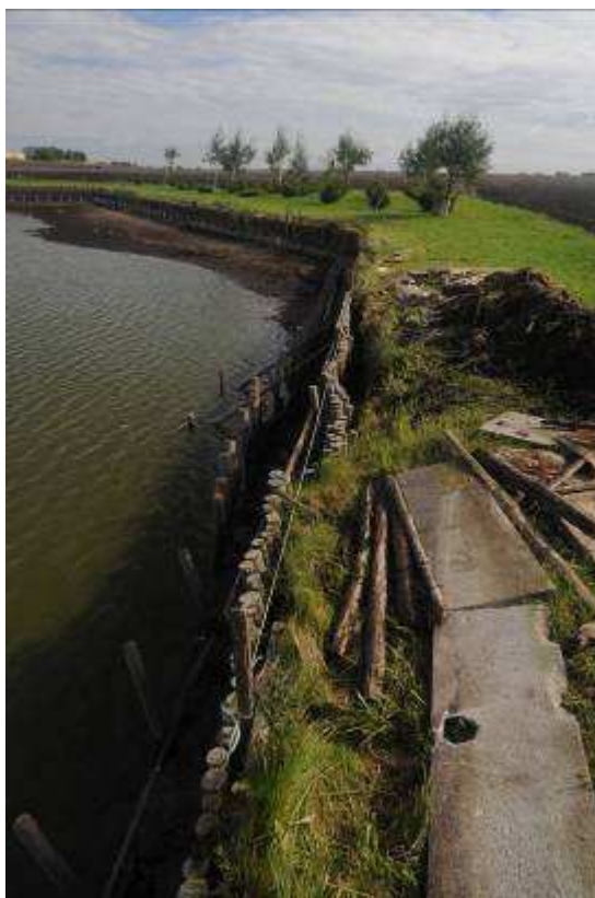
Zniszczone umocnienia brzegowe wykonane z Palisady drewnianej i płyt betonowych.
